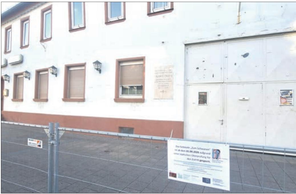
Das Schwanen-Gebäude sieht immer noch wie ein Schmuckstück am Europaplatz aus, ihm zu nahe zu kommen, könnte jedoch gefährlich werden. Der Bauzaun markiert die Gefahrenzone.
